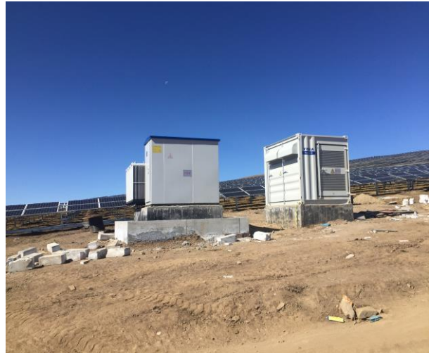
箱变及逆变器
