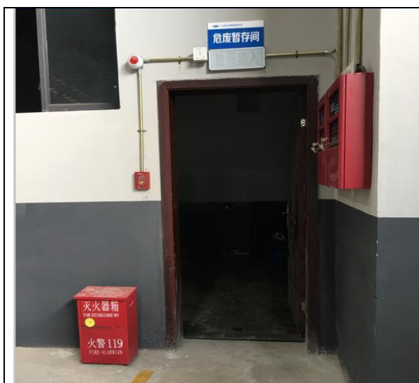
危险废物暂存间消防设施和报警装置
